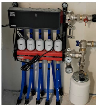
Afbeelding: vloerverwarming unit
