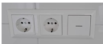
Pulsschakelaar (boven het aanrechtblad)
